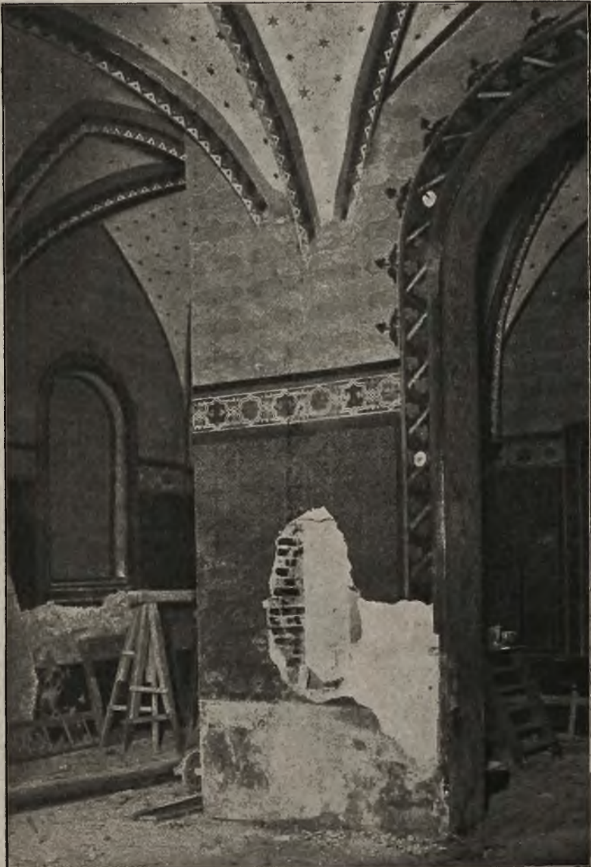
Restauracja kościoła św. Katarzyny w Krakowie: Odkrycie obmurowanego filara, podtrzymującego sklepienie kaplicy.
