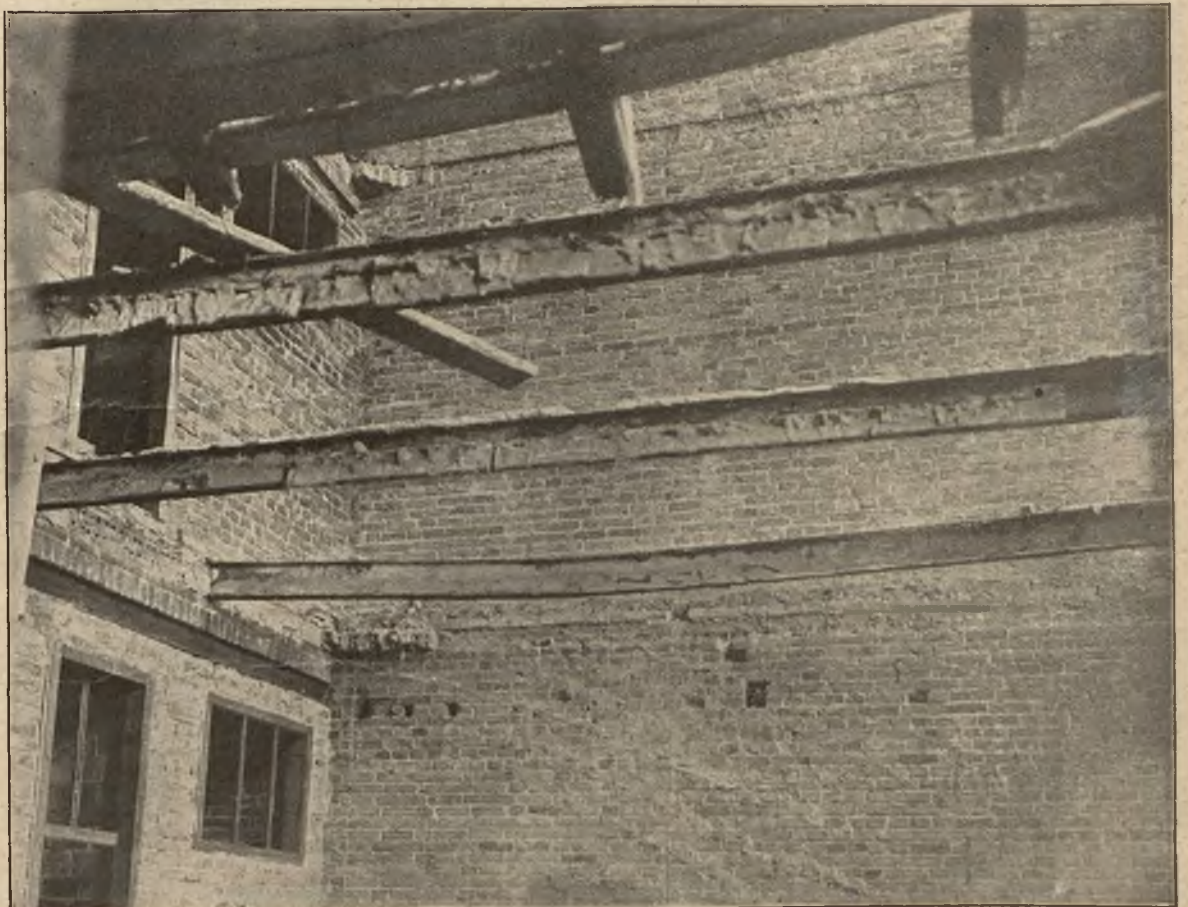
Katastrofa budowlana w Warszawie: Wnętrze trzeciego piętra po katastrofie.
