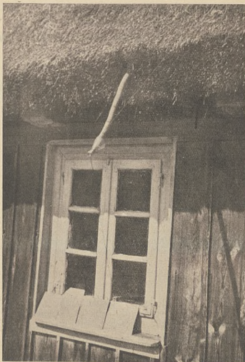
Doprowadzenie radjowe — prezesa K. Mł. Wiejskiej, kol. Zbudnielka. Należy zwrócić uwagę na prawidłowo wykonaną instalację.
